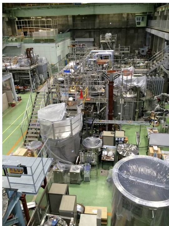
図1 NIFS超伝導マグネット研究棟の主実験室
