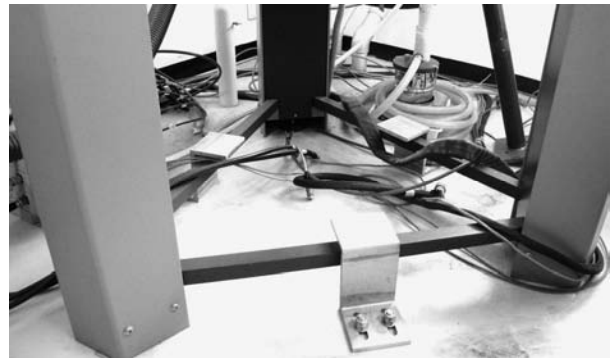
図3 震災で落下したKEK電子陽電子リニアックの四極電磁石。ビームパイプ、真空マニフォールドも破断された
